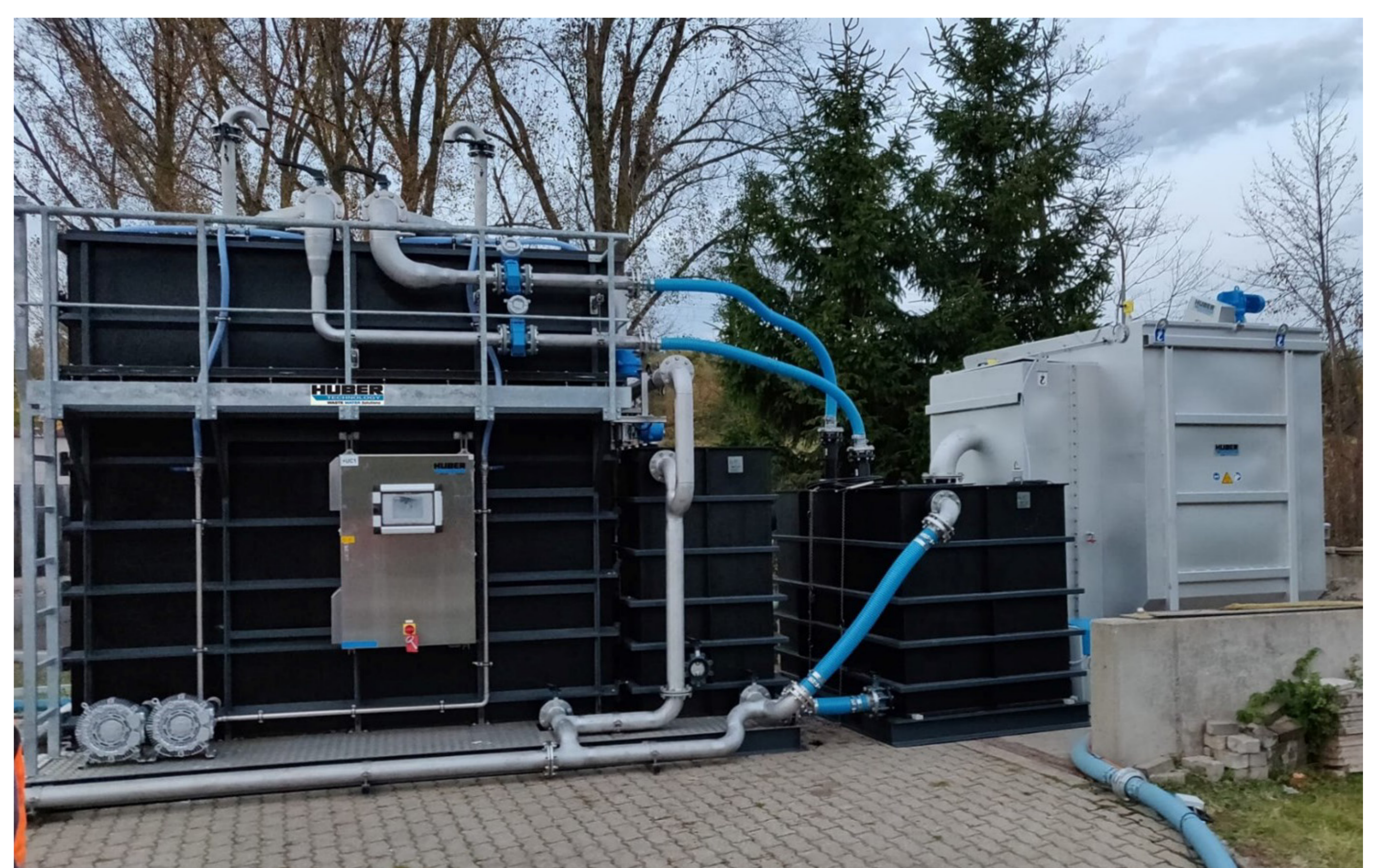
Abb. 3: Die Wasseraufbereitungsanlage (Foto: HUBER SE)
